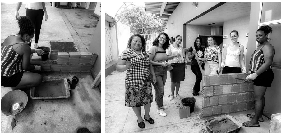
Figura 3 – À esquerda, preparação da argamassa e assentamento dos blocos cerâmicos. À direita, a parede finalizada com as mulheres participantes
